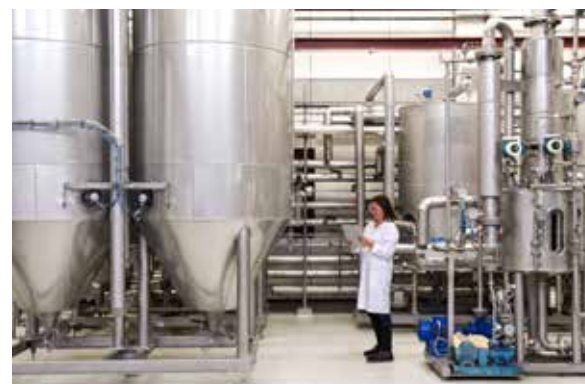
Technicienne Boccard réalisant un suivi sur une installation.
