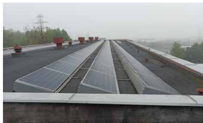
Panneaux photovoltaïques installés à Olsztyn, Pologne.
